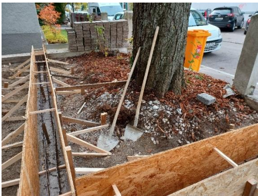
Abbildung 3: Abgrabungen im Traufbereich des Baumes
