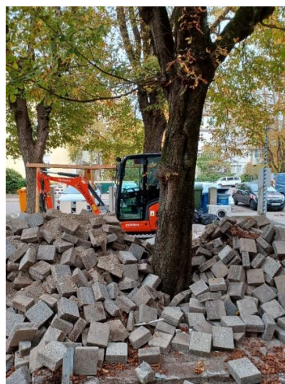
Abbildung 4: Materialablagerung im Traufbereich des Baumes
