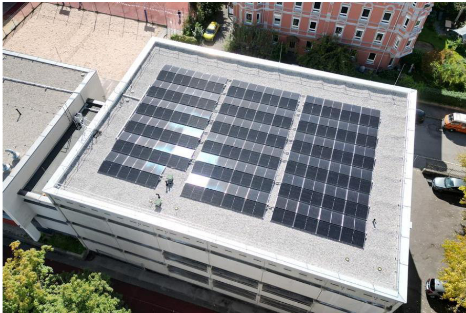
Abbildung 18: Neue PV-Anlage auf dem Turnhallendach des Jakob-Fugger-Gymnasiums
