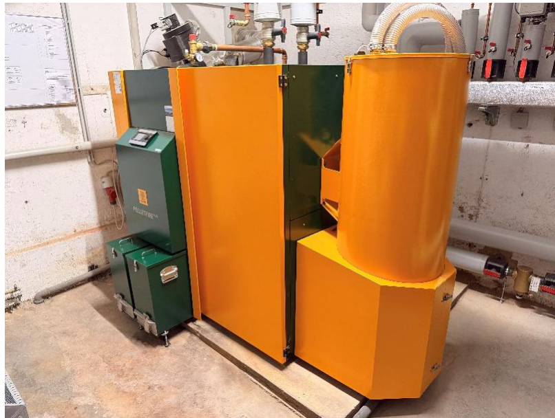
Abbildung 20: erneuerte Heizungsanlage am Nordfriedhof
