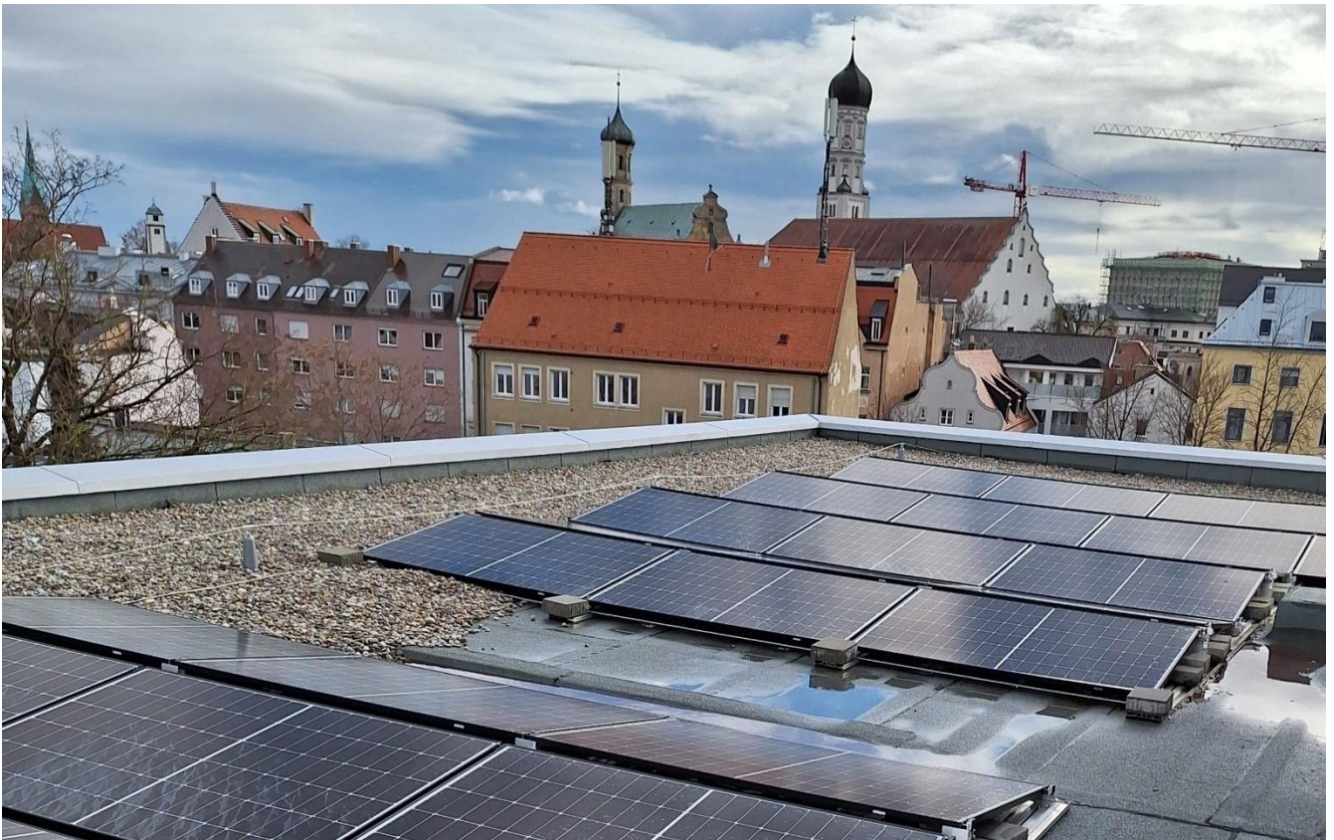
Abbildung 7: PV-Anlage auf dem Peutinger Gymnasium
