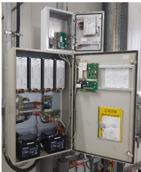
Abbildung 14; Schaltschränke für POCsag- und Tetra-Alarmierung
