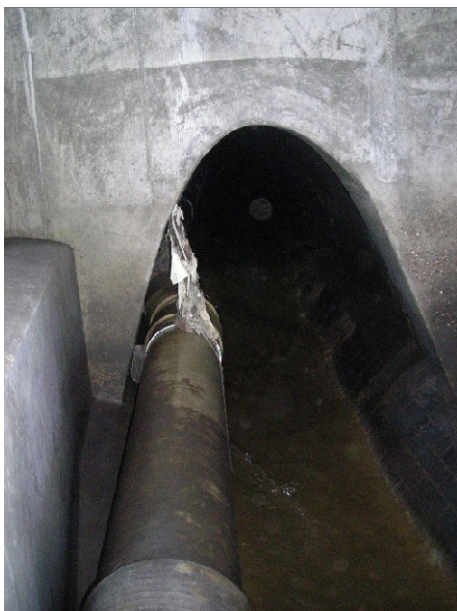
Abb. 1 In Schacht 20588035/11: Eingehängte GFK-Leitung in MW-Kanal Blick gegen die Fließrichtung
