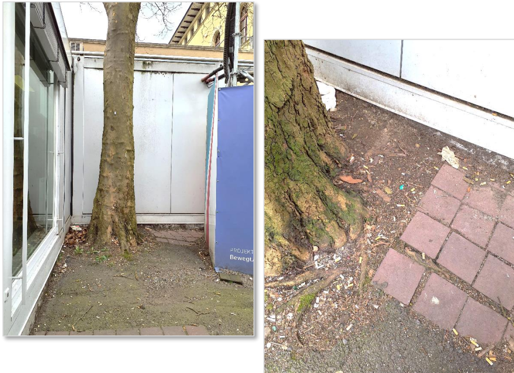
Abb. 39 Überbauter Standraum, Baum Nr. 47560
